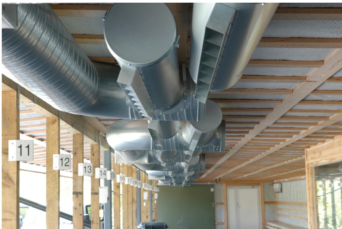
Figur 3.23 Eksempel på ventilasjonssystem montert på overbygde standplasser.
