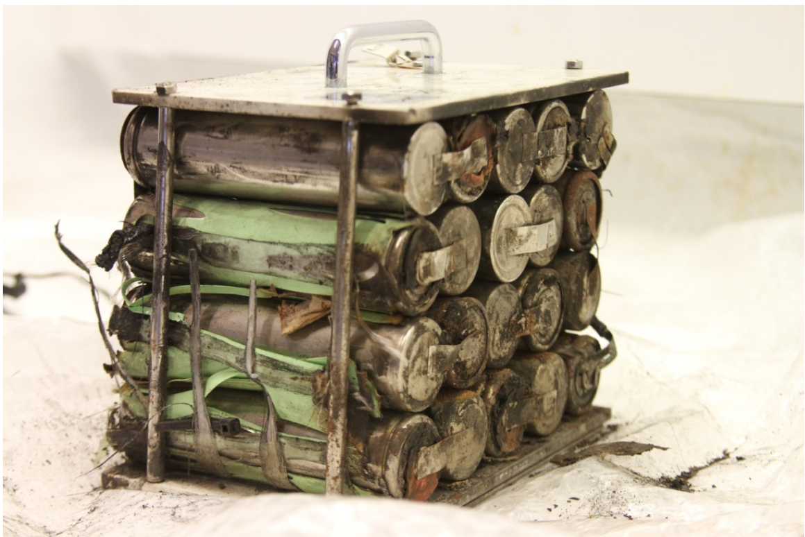
Figur 4.2 Det utbrente batteriet. Celle 8 er satt tilbake i batteriet
