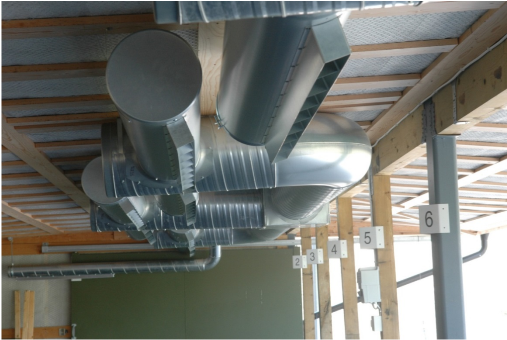
Figur 2.3 Ventilasjonssystem med sideventilasjon montert på overbygd standplass på skytebane 3 på Rena (Foto: FFI).
