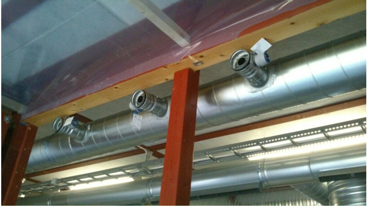
Figur 2.4 Ventilasjonssystem på støyskjermet overbygd standplass på Frigården, Stjørdal (Foto: GK Norge AS).
