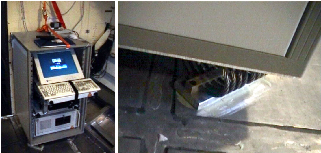
Figur 3.2 Forsterkere og PC ble plassert i et vibrasjonsdempet rack. Racket ble limt til dørken og til fremre skott i transport/opsrom.
