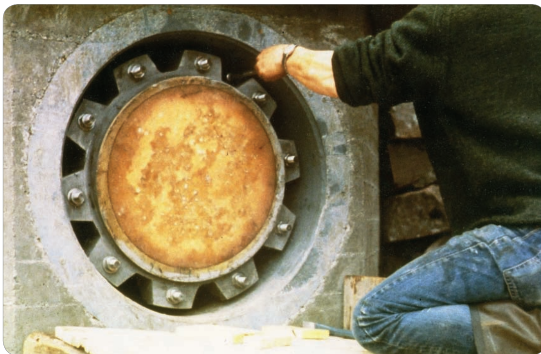
Samband trenger spesielt robuste antenner for å stå i mot trykkpåvirkningene fra kjernevåpen. Bildet viser installasjon av en slik antenne (100 Bar) ved NATO-hovedkvarteret på Kolsås. Antennen er produsert av NOVTEK A/S og FFI.
