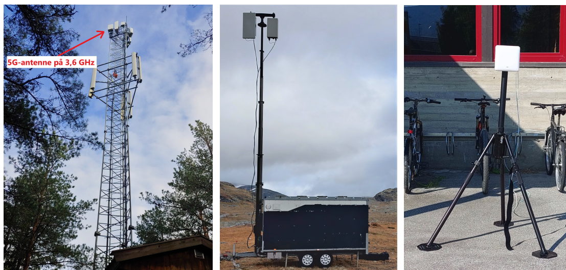
(a) Stasjonær basestasjon på Rygge, (b) Flyttbar basestasjon, makro- (c) Flyttbar basestasjon, pikocelle.
